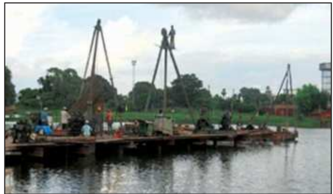
मंगलौर रिफाइनरी एवं पेट्रो-रसायन लिमिटेड के लिए चरण-III, रिफाइनरी प्रोजेक्ट, मंगलौर हेतु ऑफ-साइट मैकेनिकल निर्माण कार्य
