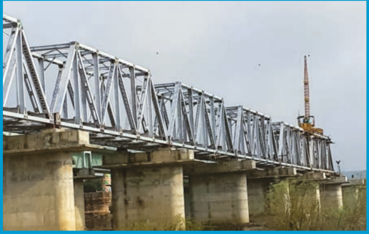
कर्नाटक में गडाग होटगी परियोजना के लिए स्टील ब्रिज का निर्माण कार्य Construction work of steel bridge for Gadag Hotgi Project at Karnataka
