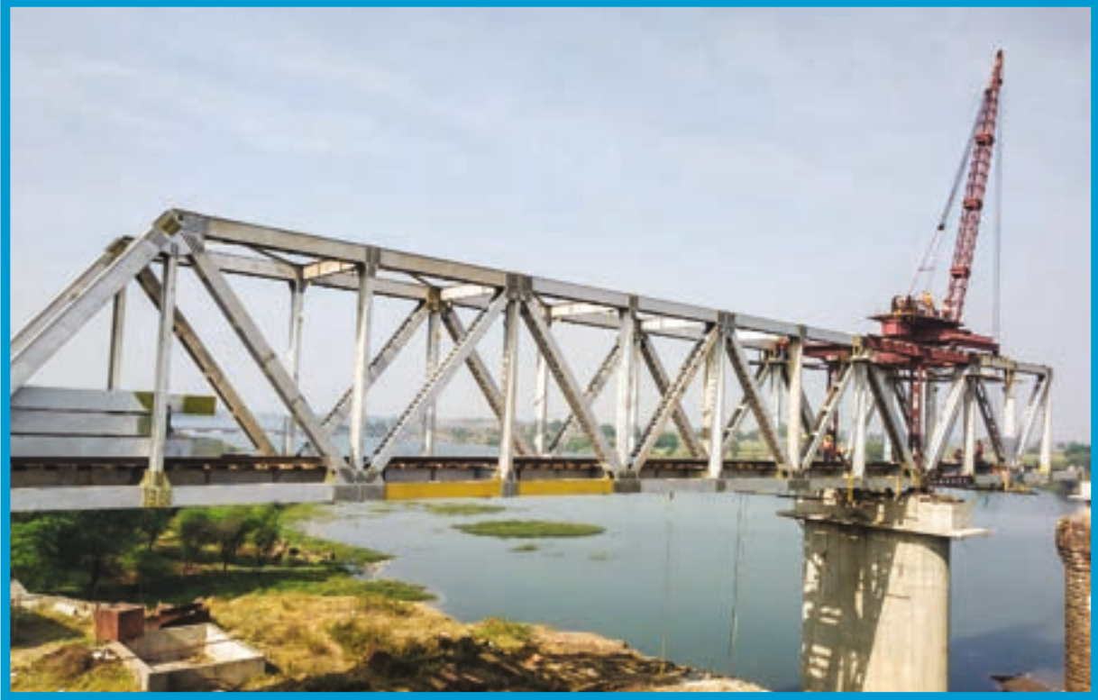
कर्नाटक में लोंडा मिराज परियोजना के लिए स्टील ब्रिज का निर्माण कार्य Construction work of steel bridge for Londa Miraj Project at Karnataka
