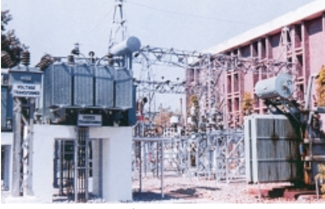
विद्युत स्थानांतर क्षमता बढ़ाने और दो समानांतर 33 केवी पारेषण लाइनों के बीच प्रणाली स्थिरता सुधारने के लिए 2 एमवीए फेज शिफ्टिंग ट्रांसफॉर्मर – फ्लैक्सबल एसी पारेषण (एफएसीटीएस) के क्षेत्र में एक अभिनव परिवर्तन
