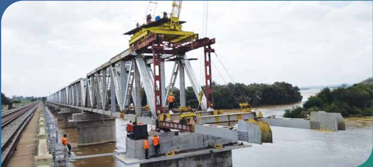
Erection is in progress for Bridge No.125 at Londa-Miraj, Karnataka. लोंडा-मिराज, कर्नाटक में पुल संख्या 125 का निर्माण कार्य प्रगति पर है।
