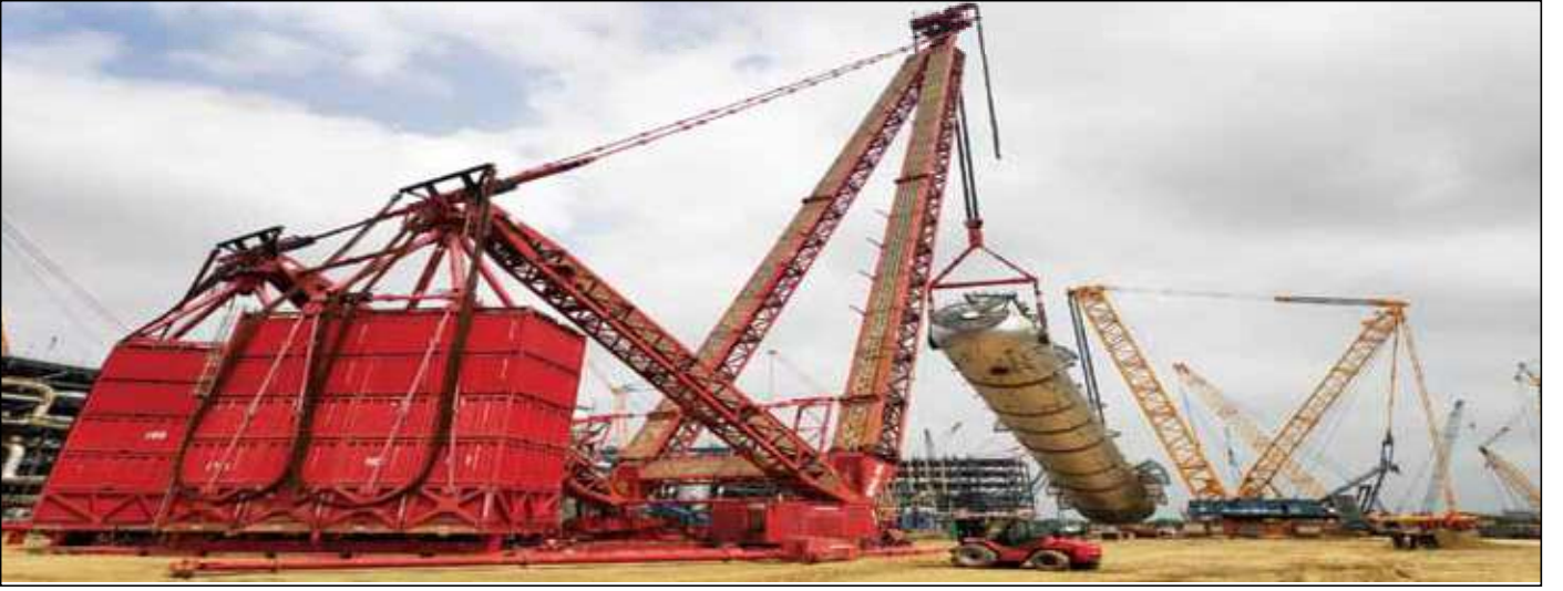
एचपीसीएल-मितल एनर्जी लिमिटेड की बठिंडा रिफ़ाइनरी में 3200 मीट्रिक टन क्रैन और 1600 मीट्रिक टन अनुगामी क्रैन द्वारा 1370 मीट्रिक टन उपकरणों का निर्माण।
